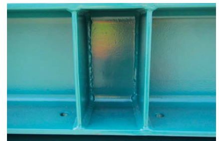
Förstärkning- och förstyrningsplåtar begränsar ofta återkomsten vid ytbehandling.
